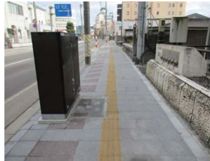
電線共同溝本体工事【上り線】 (完了後) 抜柱は次年度以降に施工予定
