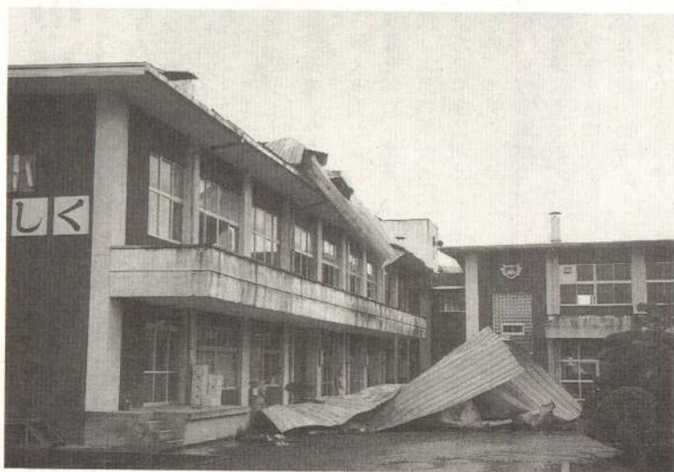
▲ トタン屋根が吹き飛ばされた南小学校。市立幼稚園、小・中学校25校の内20校に被害が
