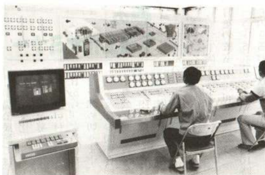
▲中央管理室ですべての施設を操作しています。
