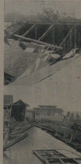
写真には有浦小学校の被害... 屋根をさらった台風15号
