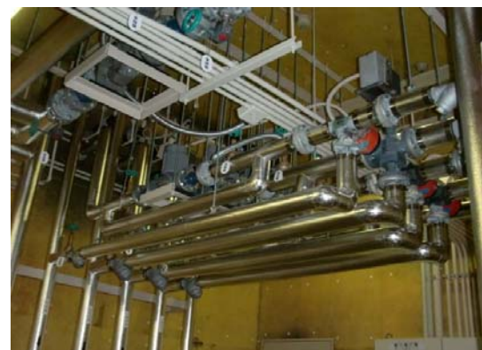
・ボイラー周辺配管設備
