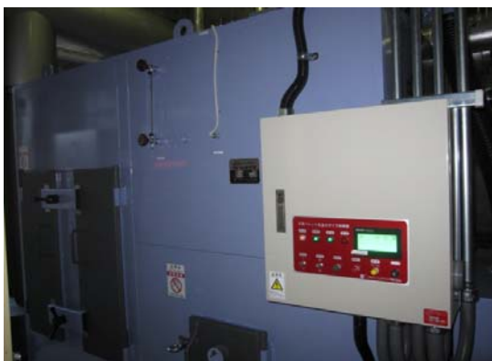
・運転制御設定盤
