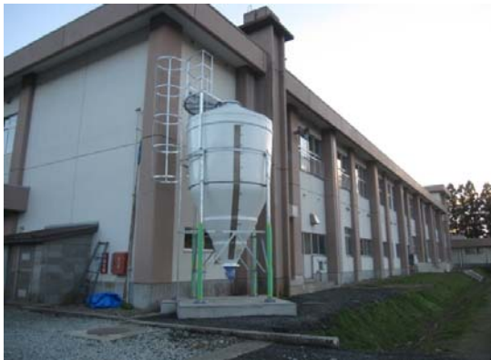
・ペレット貯蔵施設(燃料タンク)
