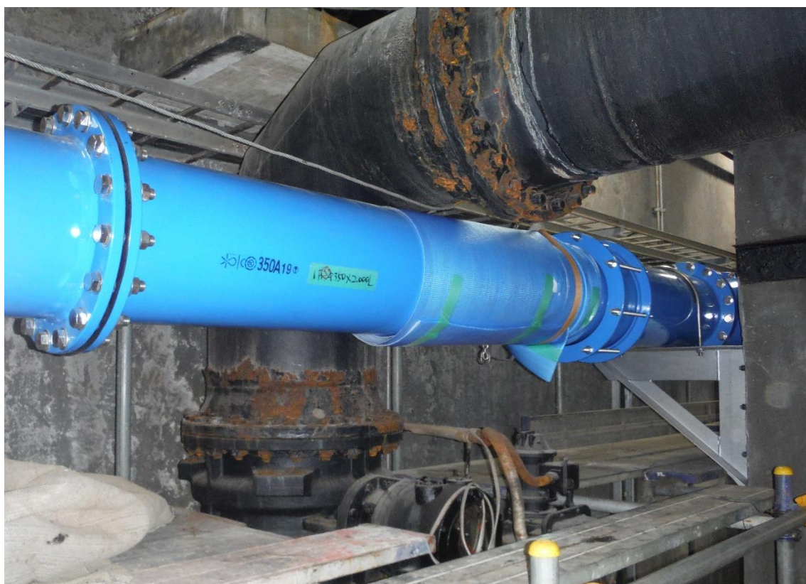
更新した管路と老朽化がすすむ場内配管 (山館浄水場ろ過施設地下配管)
