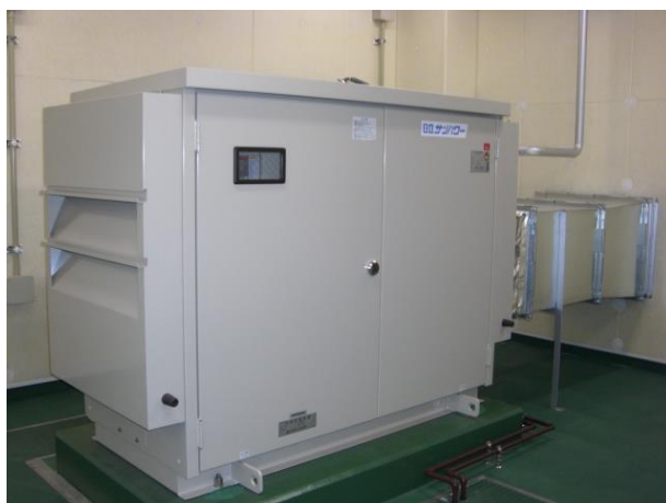
矢立浄水場 発電発電機
