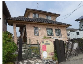
全壊となった在来軸組工法住宅 ※秋田県立大学 板垣 直行 氏提供
