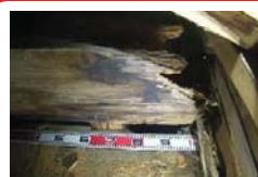
親梁の腐食状況(横から)
