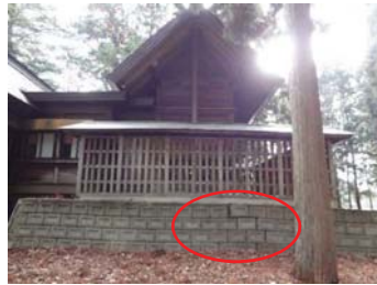
盛土基礎ブロックのクラック状況
