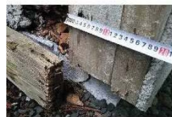
柱外部(腐食状況)
