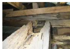
親梁の腐食状況(上から)
