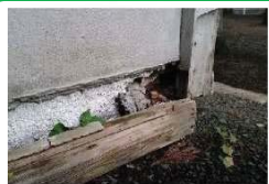
土台外部(腐食状況)
