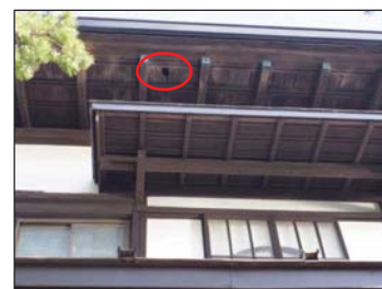
(写真) 軒天に穴あり
