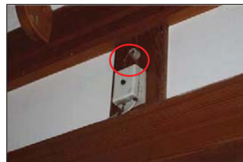
(写真) 配線が露出している
