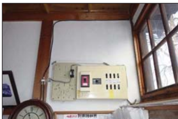
(写真) 耐用年数を経過している分電盤
