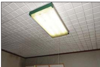
(写真) バックヤードの照明器具
