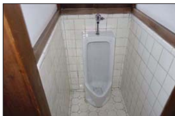
(写真) 冬季は給水管が凍結している
