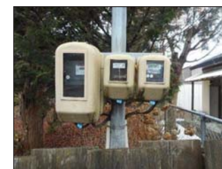
(写真) 引込開閉器盤
