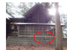
盛土基礎ブロックのクラック
