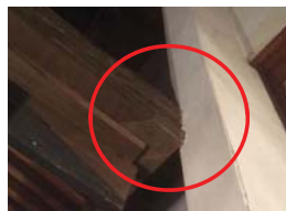
正八幡宮と覆屋の壁柱の接触
