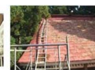
屋根塗装剥離
