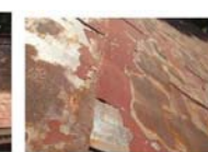
塗装剥離(拡大)
