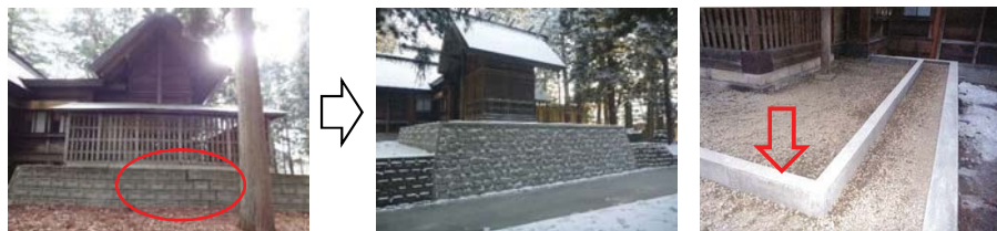
【着手前】 盛土基礎ブロックのクラック状況
