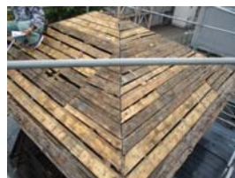
檼屋根野地板(腐食状況)
