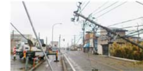
(1) 電柱の倒壊状況
