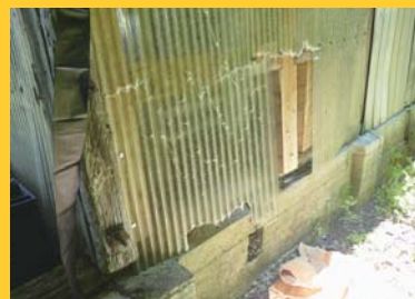
壁の破れた部分から侵入する事例もあります
